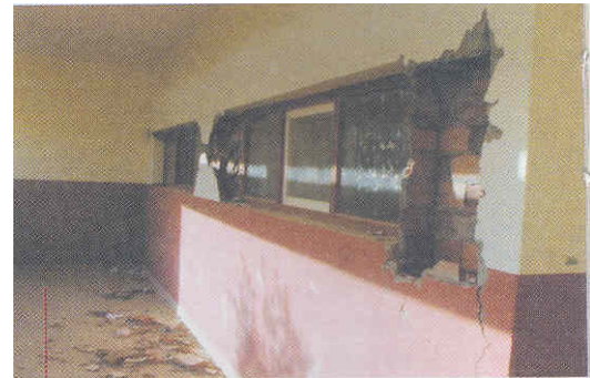
Lycée Imzouren : désordre type des classes côté couloir : démolition ou fissure des trumeaux par effet de cisaillement
