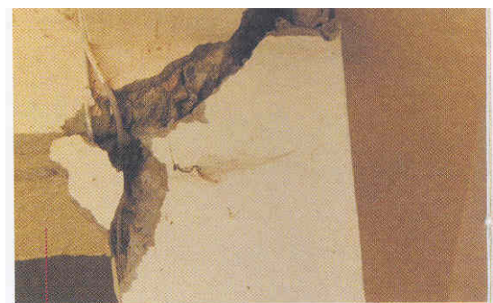
Collège Al Qods : fracture au nœud du poteau du RDC au bloc 1 accolé à la cage de l'escalier
